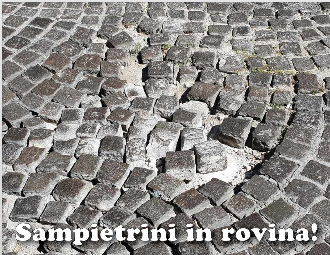
Un dettaglio della situazione di via Porta Lecce: urge intervenire!
